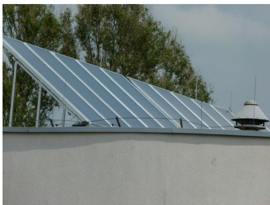
Solary Wodociągów Kieleckich ustawione są pod kątem 45 stopni
