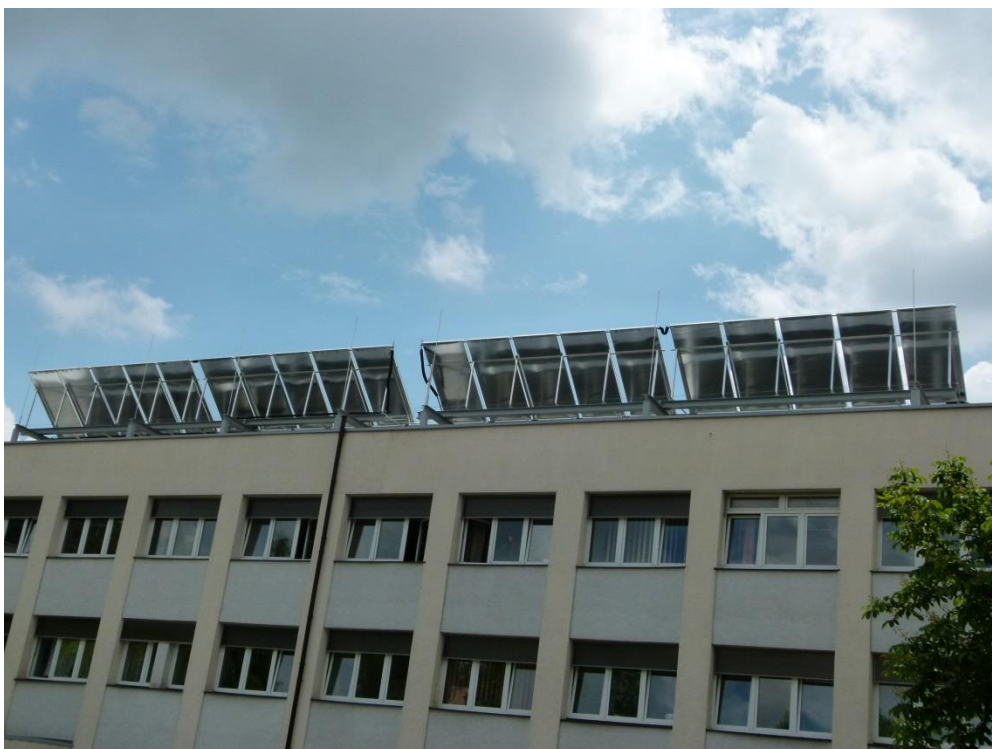
Instalacja solarna pozyskiwania ciepłej wody na budynku administracyjnym Wodociągów Kieleckich przy ul. Krakowskiej 64
